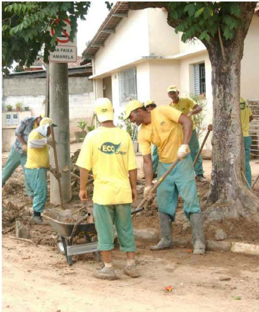
Trabalhadores removem lama e entulho no Jardim Boa Esperança, ontem
